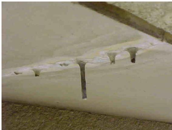
コンクリートつらら
