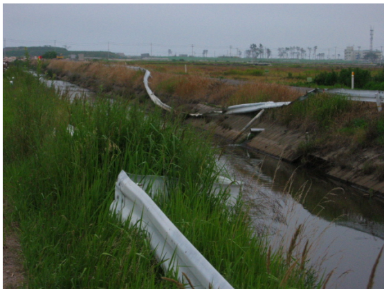
図 1-1 未整備の灌漑水路 仙台市若林区荒浜（2012.8.3 筆者撮影）
